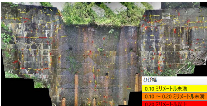
橋梁点検：AIによるクラック自動判別
